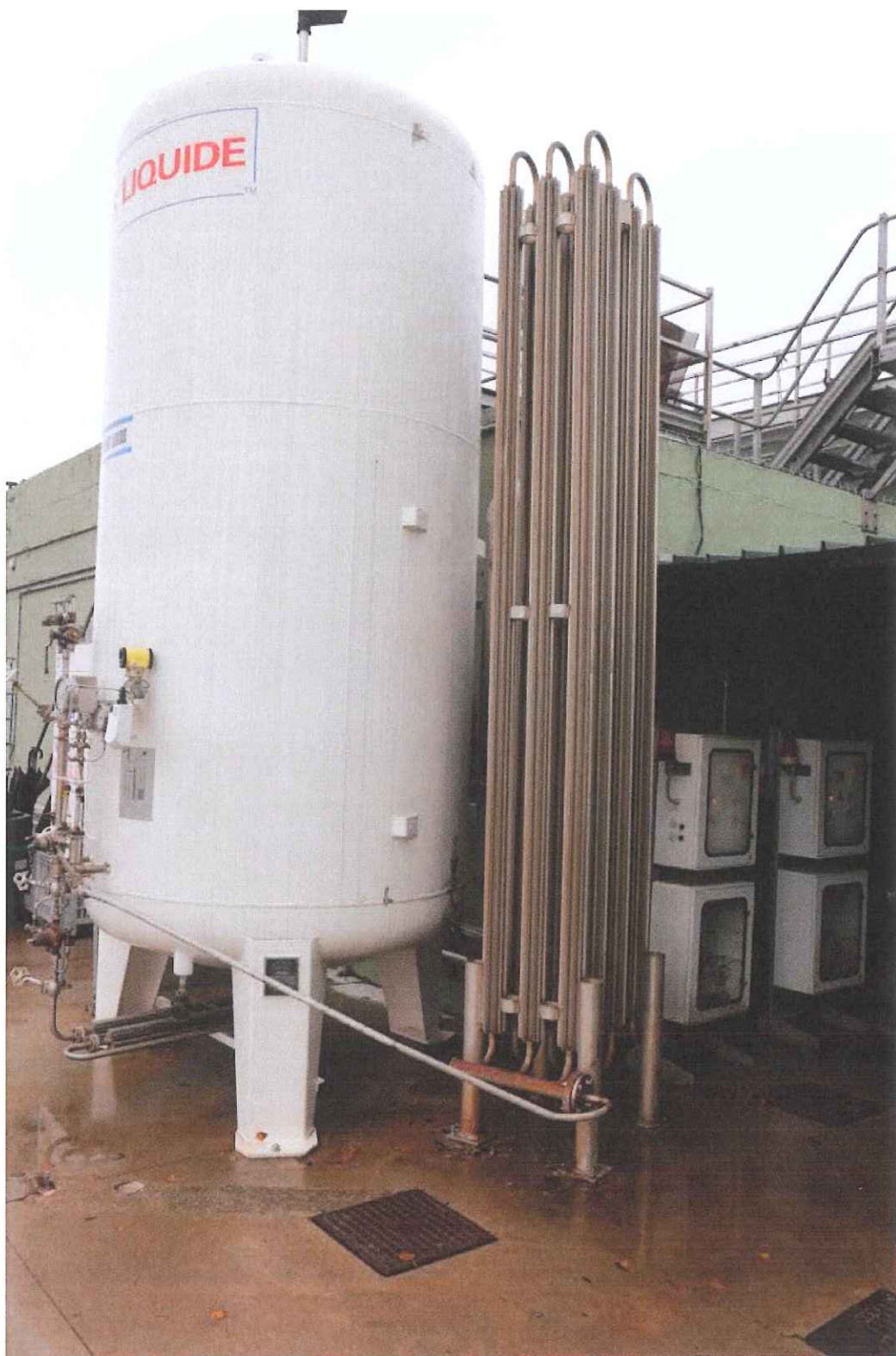
Foto 5 L'impianto di depurazione: Criocentinitore, evaporatore e quadri distribuzione
