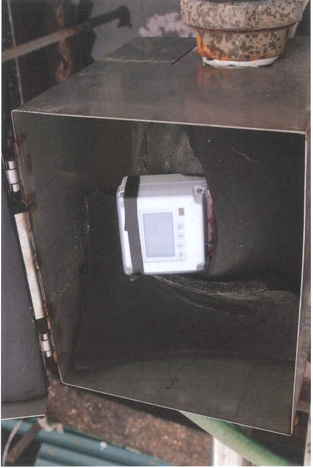
Foto 4 L'impianto di depurazione: Dettaglio contatore
