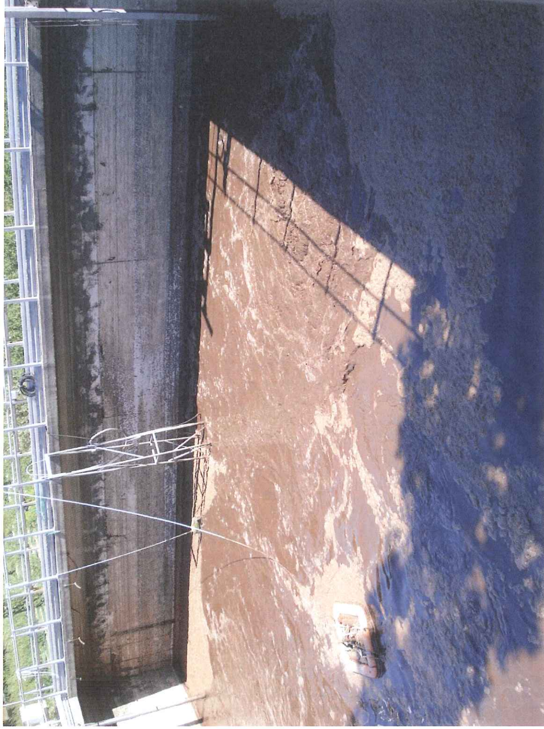
Foto 2 L'impianto di depurazione: vasche di equalizzazione-ossidazione
